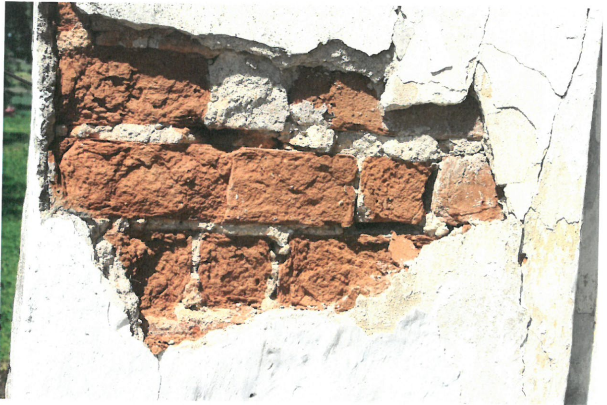
BAJKI ZALESIE KAPLICZKA DWORSKA. STAN W CZERWCU 2013
